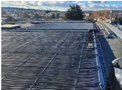
Capteurs solaire EPDM en toiture
